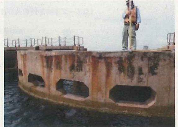
本体コンクリートの劣化状況
